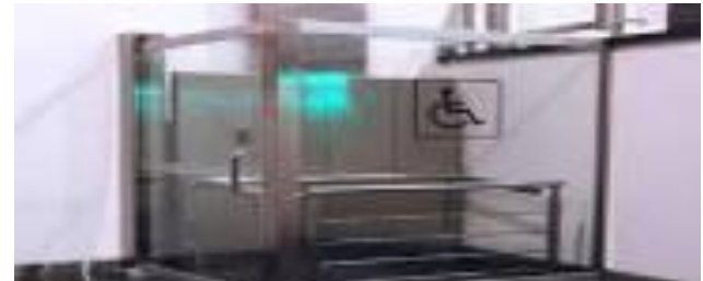
Ascensores para Discapacitados
